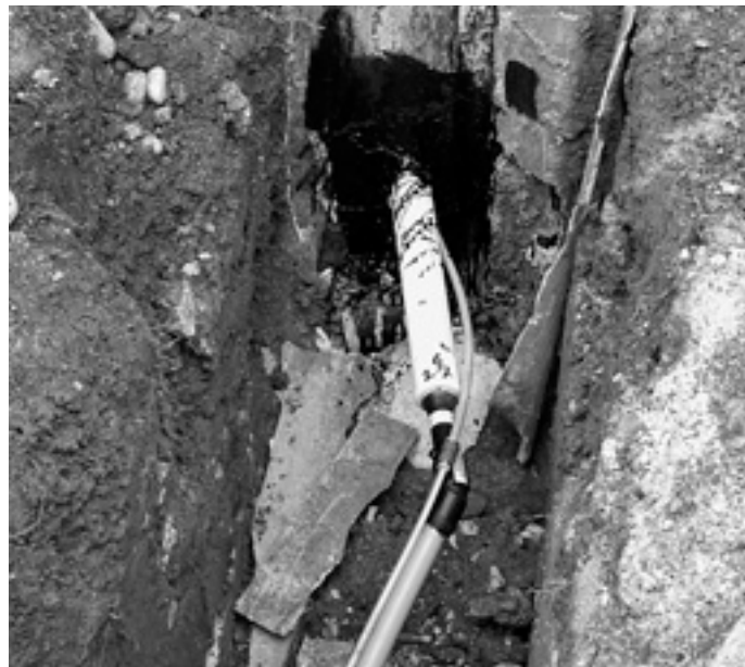
So sieht der Hausanschluss für Erdgas und schnelles Internet aus
